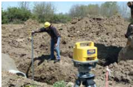
Elimina comprobaciones de cota peligrosas en el interior de una zanja o al asomarse sobre la misma
